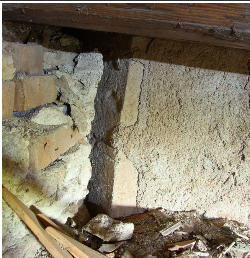
Detail armování severovýchodního nároží presbytáře patrné ve styku koruny východního zdiva sakristie v jejím podkrovní. Foto: Jaroslav Skopec 2019.
